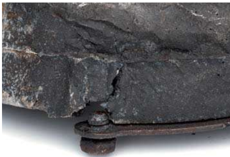
Abb. 1 Riss im Turbinengehäuse
